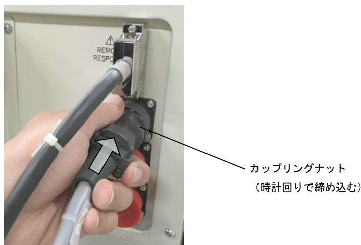
図 4-17 冷凍機駆動ケーブルの接続
