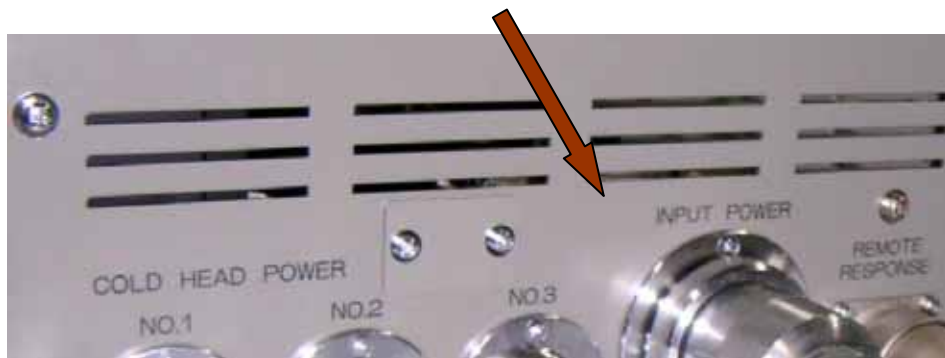
図 4-5 電源ケーブルコネクタの接続
