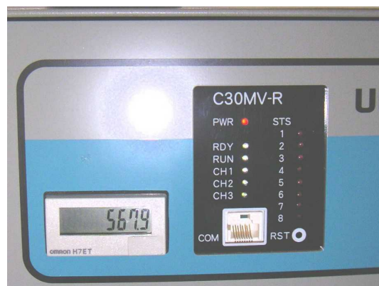
図 5-4 C30MVR 運転中のステータス表示
